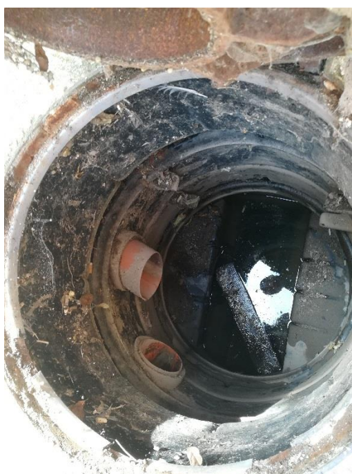
Slika 43. Uzdužni pomaci (razmaknuti spojevi) u PE dijelovima revizijskog okna
