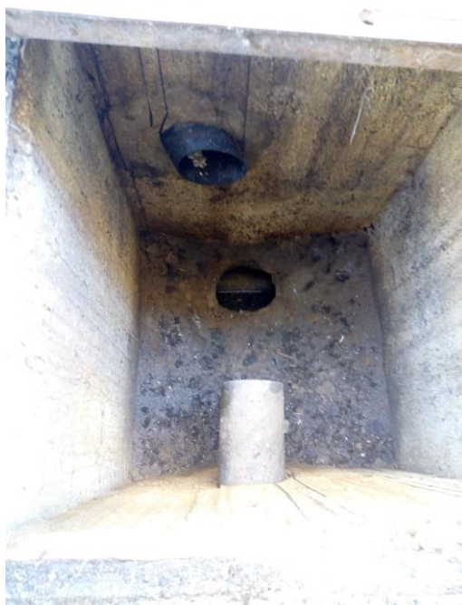
Slika 40. Neispravno izvedena kineta u oknu
