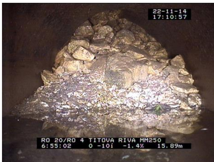
Slika 44. Urušenje u cjevovodu – nemogućnost instalacije CIPP cijevi
