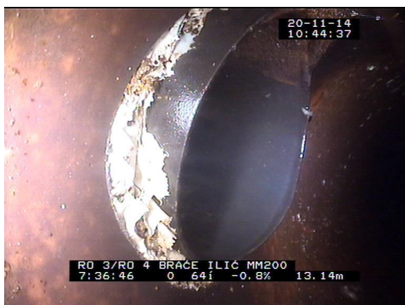
Slika 13. Nepravilno ugrađen priključak
