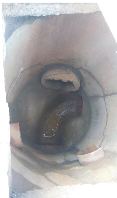
Slika 38. Oštećenja betonskih revizijskih okana, poprečne pukotine
