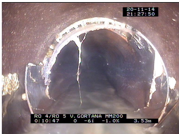
Slika 15. Oštećenja keramičkih cjevovoda
