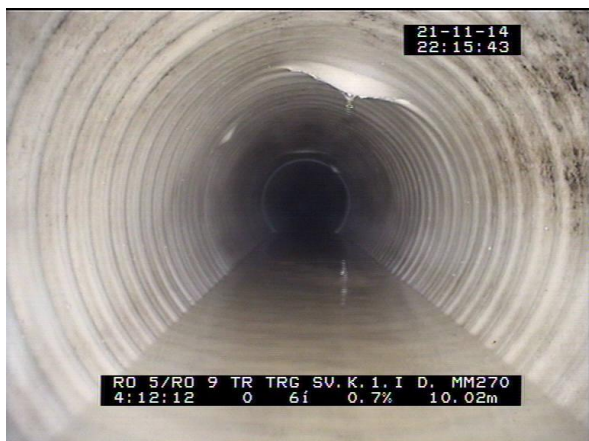
Slika 17. Oštećenja PP cjevovoda
